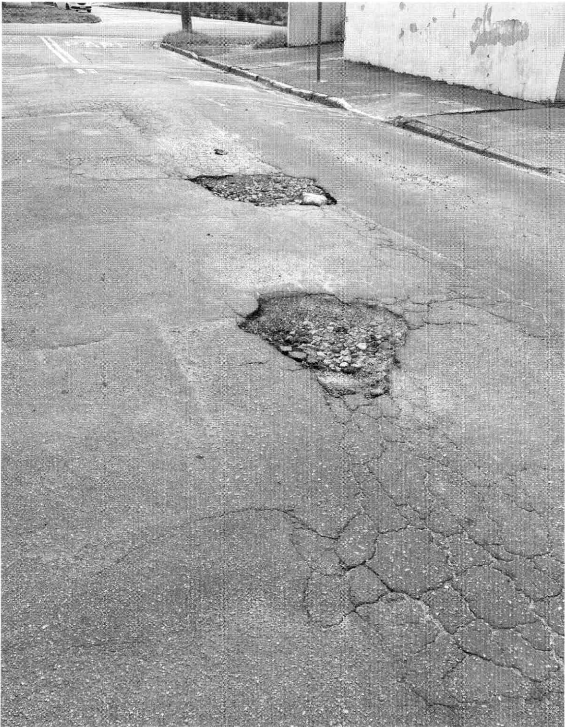
MANUTENÇÃO ASFÁLTICA EM TODA A EXTENSÃO DA RUA IVAN MENDES PINTO, JARDIM ESPERANÇA- MOGI DAS CRUZES.
